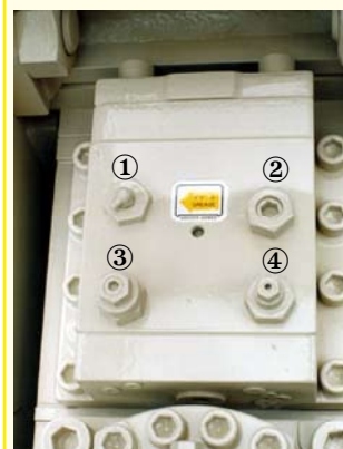
Valve de contrôle
